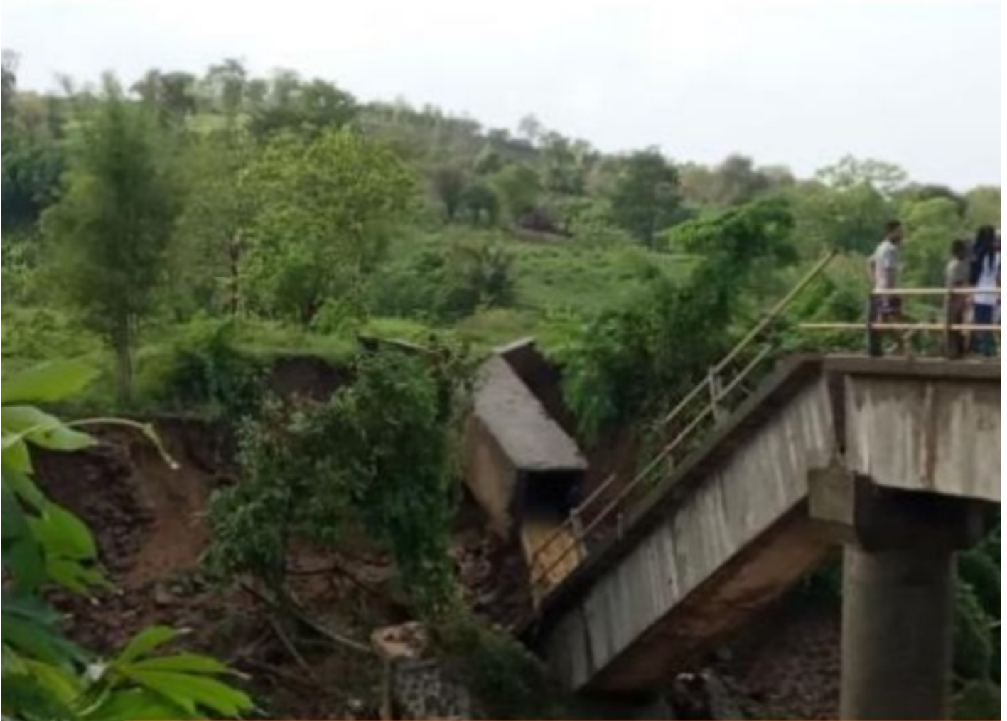
Jembatan Roboh akibat Banjir Bandeng di Lundyk, Sumbawa, (09/10)
